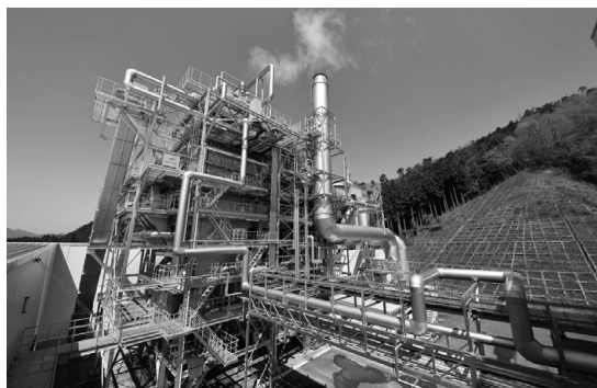
真庭バイオマス発電所
